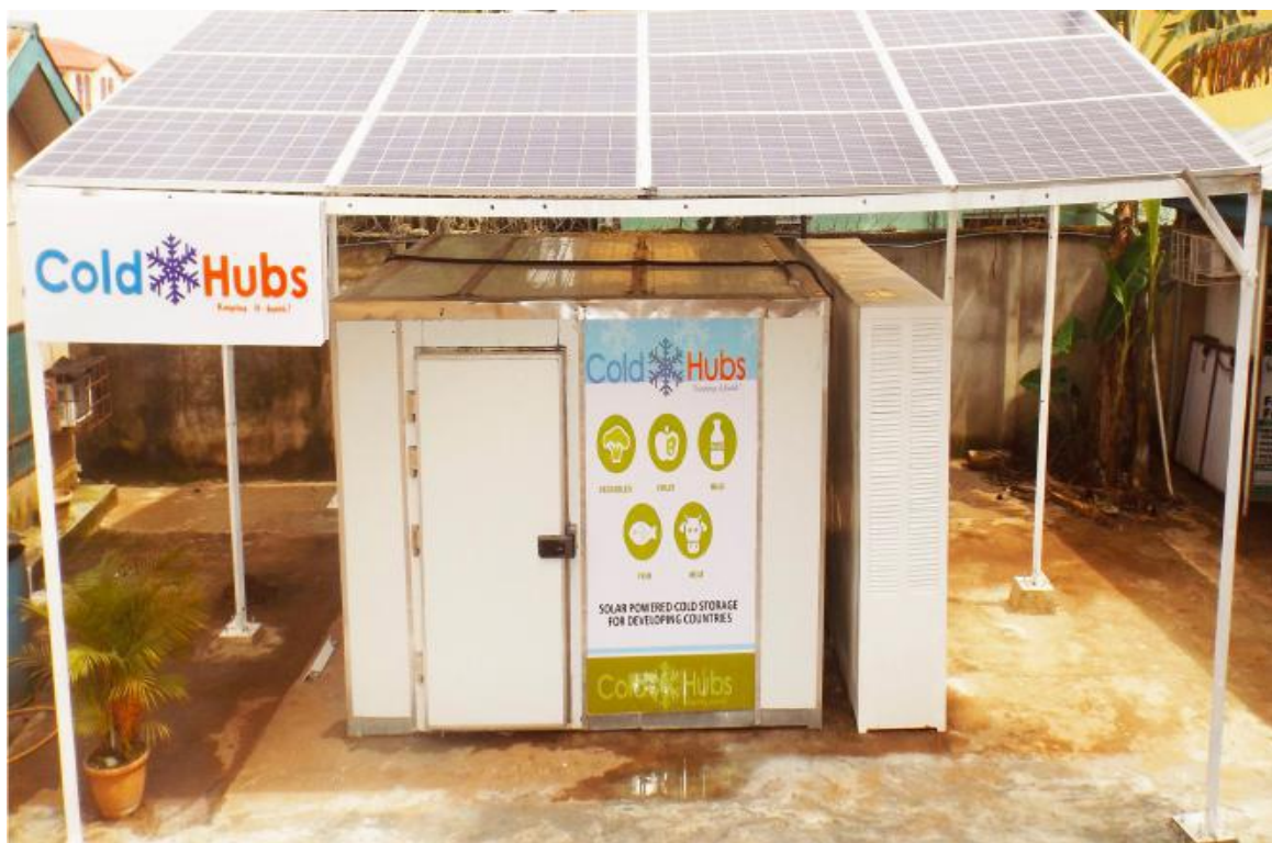
Stoccaggio freddo a energia solare, Nigeria
